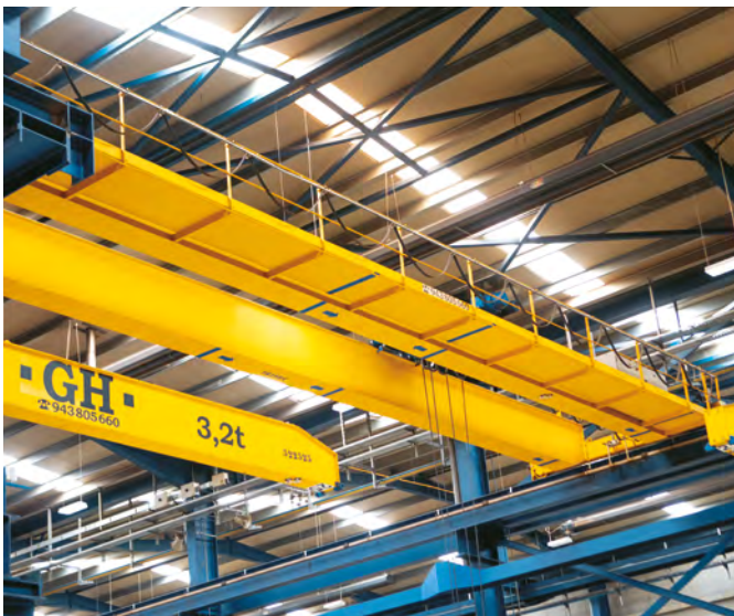
PASSERELLE DE MAINTENANCE. PLATELAGES SUR PALAN.
